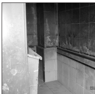
Wypalona komora zsykowa w budynku przy ul. Tolstoja 11.
